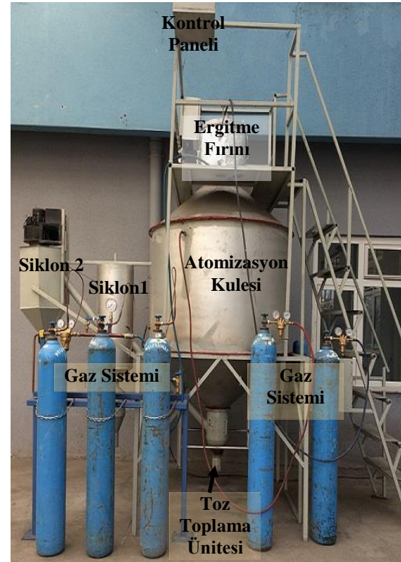
Şekil 1. Gaz Atomizasyon Ünitesi
