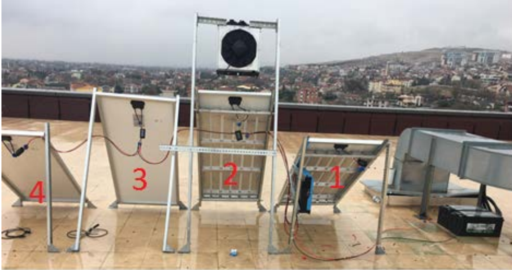
Şekil 2. Kurulan sistemin arkadan görünüşü (Figure 2. Rear view of the installed system)
