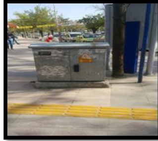
Şekil 23. Necip Fazıl Kısakürek Sokağı üzerinde yer alan trafo
