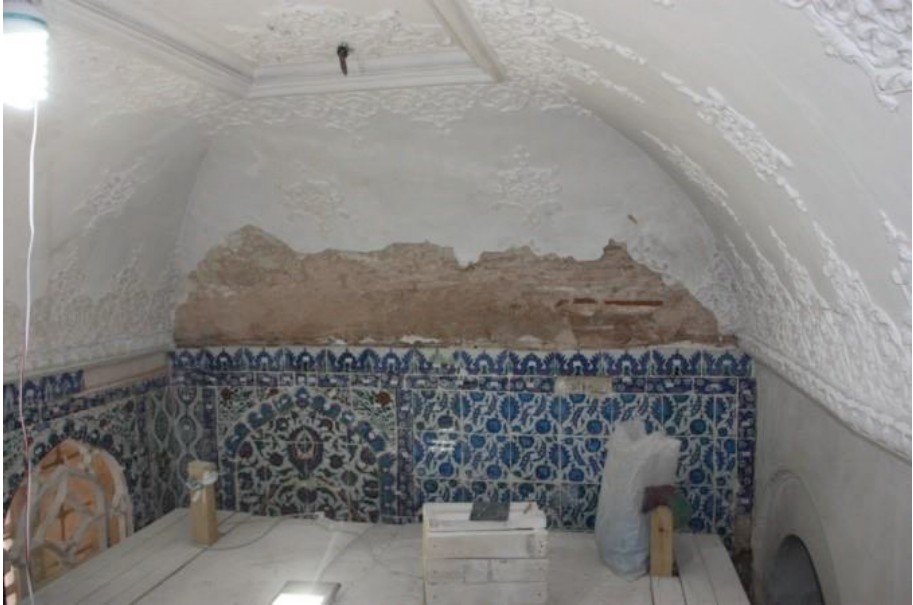
Foto 22: Restorasyon Öncesi Hazine-İ Kütüb Bölümünü Tonozunun Durumu.
