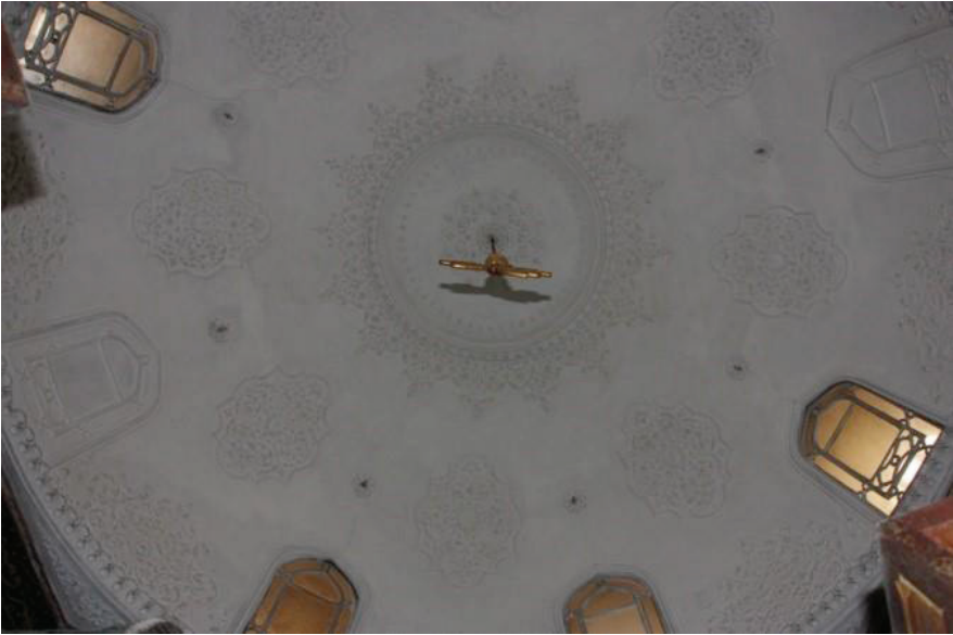
Foto. 20: Restorasyon Öncesi Hazine-İ Kütüb Bölümü Kubbesi
