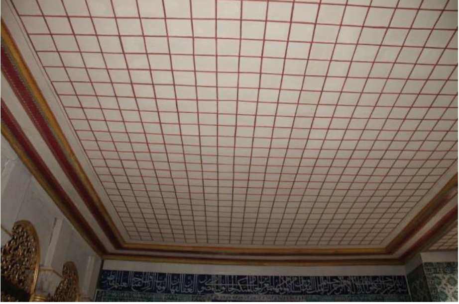
Foto. 11: Restorasyon Sonrası Okuma Odası Tavanının Durumu.
