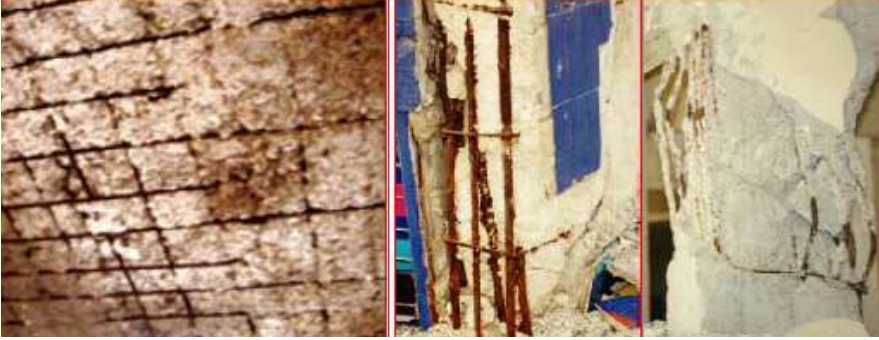
Şekil 5. Korozyona uğramış yapı elemanları örnekleri (Doğan (2009)).
