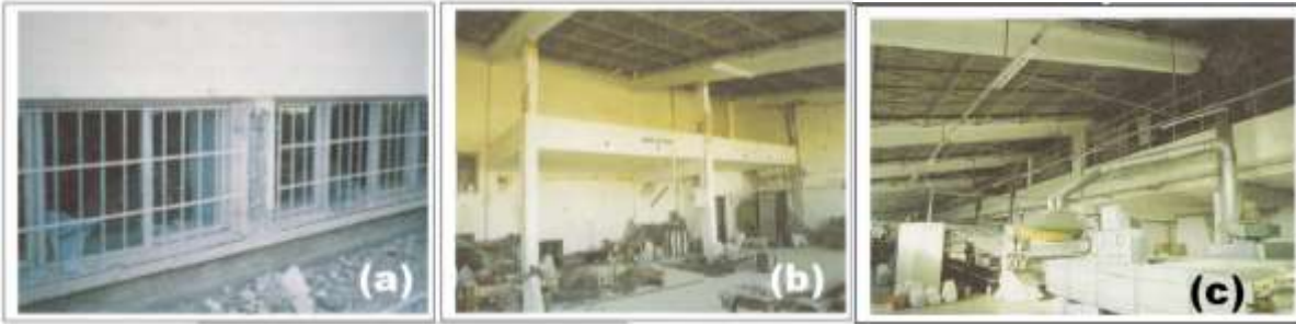
Şekil 8. 1995 Dinar depreminde gözlenen kısa kolon hasarı örnekleri (ODTÜ(1995)).
