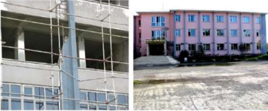
Şekil 15. Van depreminden sonra kamu binalarında bant pencerelerin oluşturduğu kısa kolon hasarlarına örnekler (Alan ve ark. (2011)).
