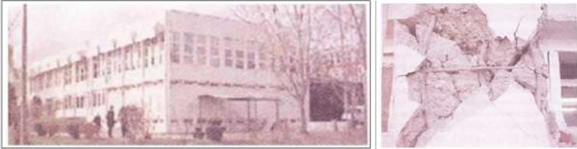
Şekil 10. 1999 Düzce depremi sonrası görülen kısa kolon hasarı örneği (Özcebe (1999)).
