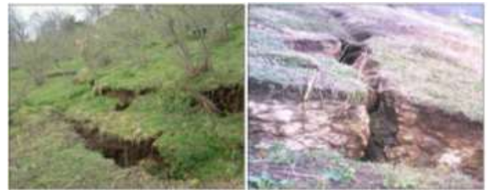
Şekil 4. Kayma sonucu şev gerisinde oluşan gerilme çatlakları (Erçikdi ve ark., 2006)
