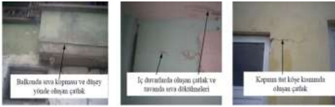
Şekil 1. Çevredeki yapılarda önceki atımlar sonucu oluştuğu düşünülen çatlaklar (Erçikdi ve ark., 2004a)
