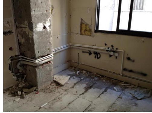
Şekil 2. Temiz su tesisatı (URL-3).
