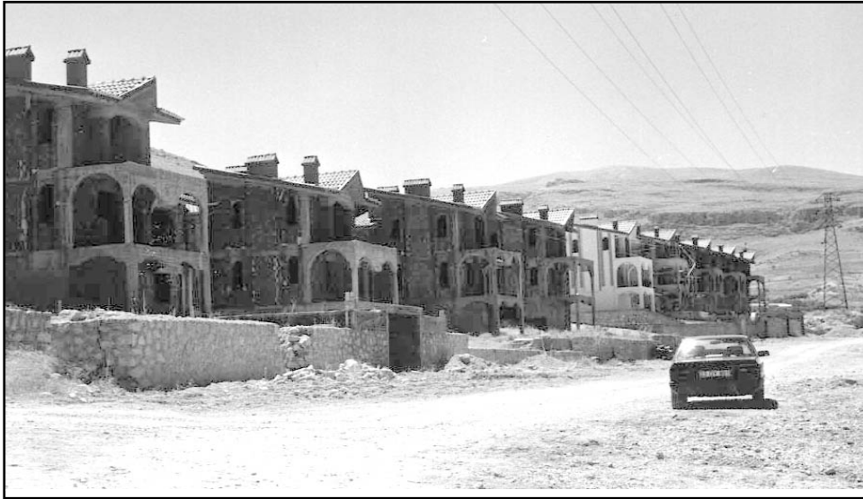
Foto 6: Evler inşa aşamasında iken zemin problemleri nedeniyle istinat (1) ve ev duvarlarında (2) yarıklar oluşmuş, bunları önlemek amacıyla kiltaş kalker kontağından çıkan kaynaklar drene edilmiş ve istinat duvarları yapılmıştır.
