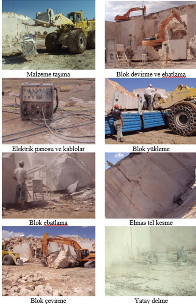
Şekil 4. Gözlenen bazı ihmaller ve hatalı davranışlar (Some observed negligence and failure behaviors)
