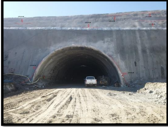
Şekil 7. Tünel girişi portalında oluşan çatlaklar
