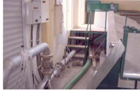
Şekil 9. Boru hattı (Pipeline)
