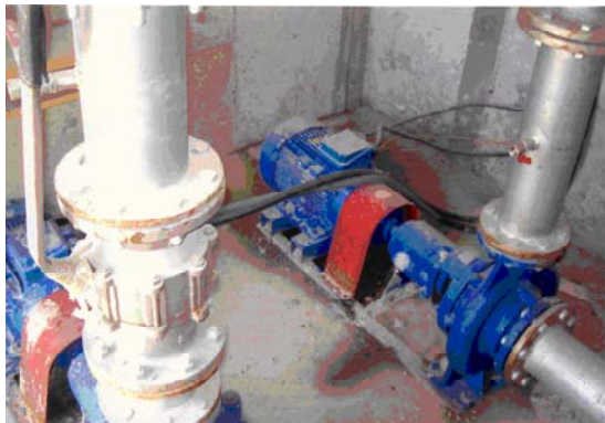
Şekil 7. pompa odasının içi (Inside of the pump chamber)
