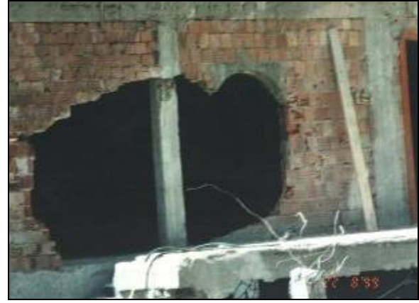
Şekil 20. Bir dolgu duvarın düzlem dışı kırılışı (Out-of-plane failure of an infill wall)
