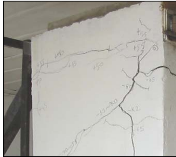
Şekil 18. Güç tüketimi konumunda oluşan köşe çatlakları (Close-up view of corner cracks at failure)
