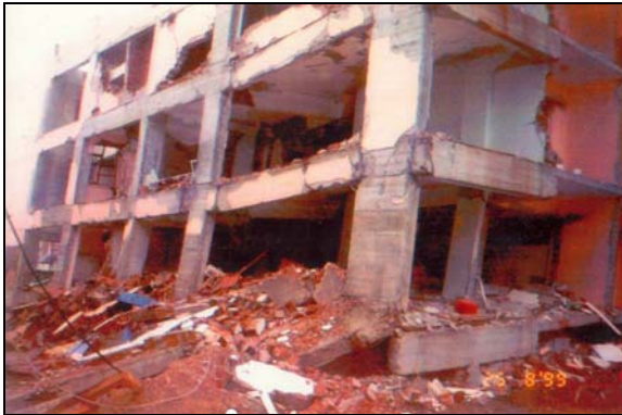
Şekil 1. Betonarme çerçeveli yapıda dolgu duvarların düzlem dışı kırılması (Out-of-plane failure of infill walls)
