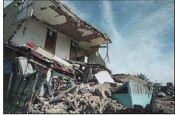
Şekil 2. Yığma duvarın düzlem dışı kırılması (Bam Depremi, 2004) (Out-of-plane failure of a load bearing masonry wall (Bam Earthquake, 2004))
