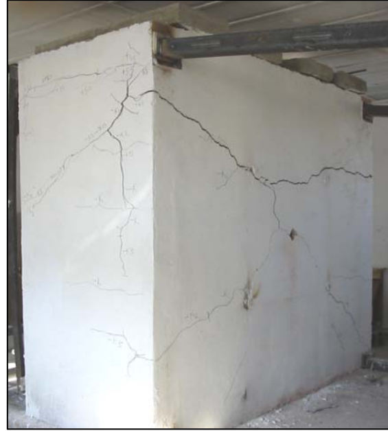
Şekil 17. Güç tüketimi konumunda oluşan çatlak haritası (Cracking pattern of the test wall at failure)
