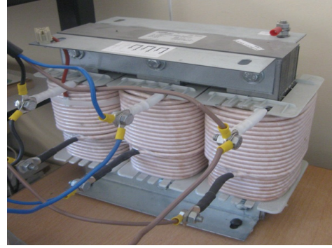
Şekil 6. D-STATKOM deneysel kurulumunda kullanılan üç fazlı bağlantı endüktası (Three-phase coupling inductance used for D-STATCOM experimental setup)
