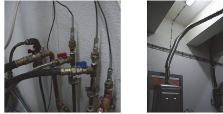
Şekil 9. Sıcaklık problemlerinin yakından görünümü ve kombi baca bağlantısı (Close view of the temperature probes and chimney connection)
