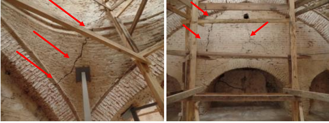
Şekil 12. İmaret bölümü yığma örgüsünde meydana gelen yapısal çatlak ve ayrışmalar
