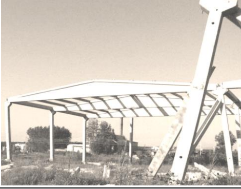
a) Taşıyıcı sistemin genel hasarı
