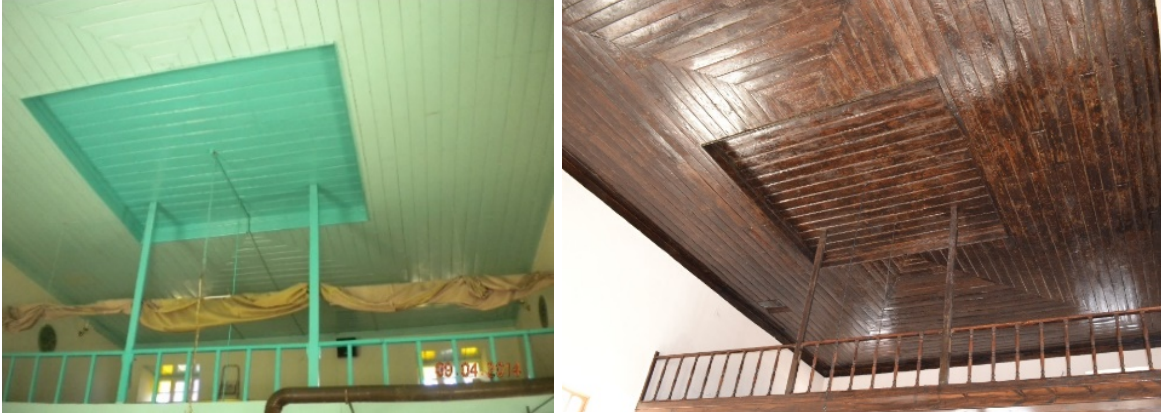
Fotoğraf 9- Karacaşehir Camisi restorasyon öncesi ve sonrası çökertme tavan
