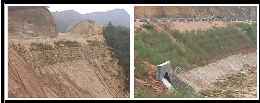
Şekil 11. Güney Çin'de 1997 yılında Jiangxi karayolu kenarında dik bir dolgu stabilizasyonunda Vetiver grass bitkisi kullanımı (URL-4, 2011)
