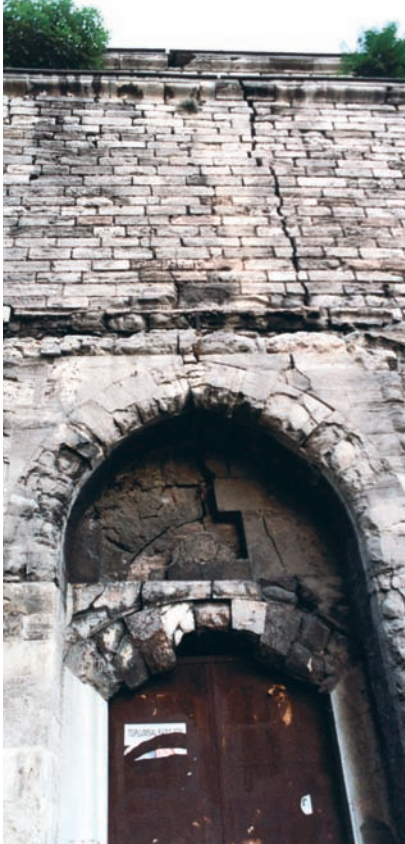
Resim 11. 1999 depremi sonrası yapıda meydana gelen çatlaklar, 2000
