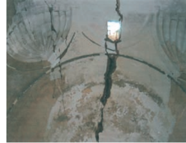
Resim 16. II. Bayezid Hamamı'nın kubbesindeki çatlaklar
