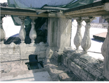
Resim 6. Çatı parapetinde oluşan bozulmalar (bazıları yok olmuş elemanlar)
