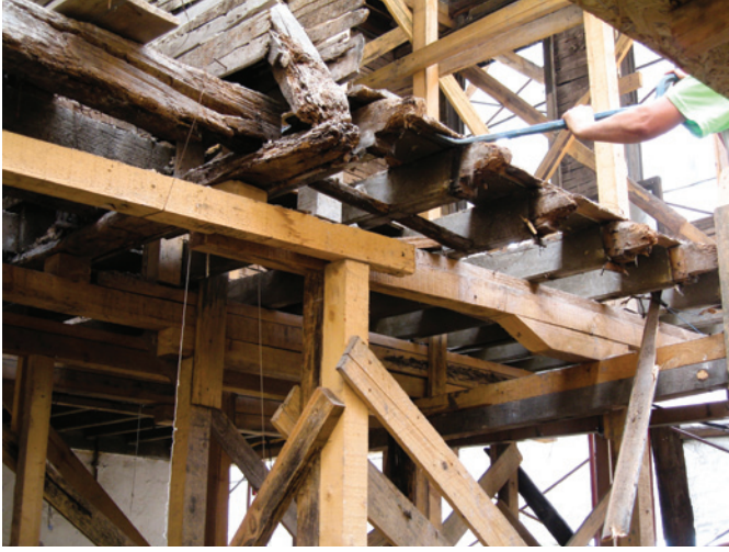
Resim 34. Uç kısımları hasarlı olan döşeme kirişleri
