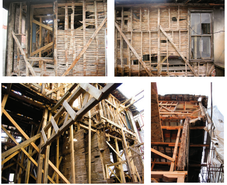
Resim 24. Yapının kuzey duvarının onarım öncesi durumu
