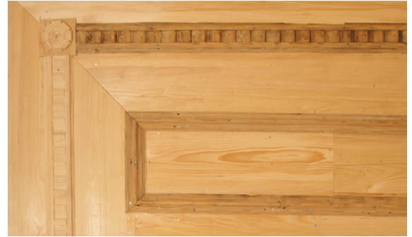
Şekil 19. Ahşap yapı elemanında bütünleme örneği (KUDEB Rest. ve Kons. Lab., 2012)
