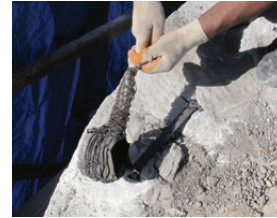
Eksik metal elemanların kurşun ile monte edilmesi
