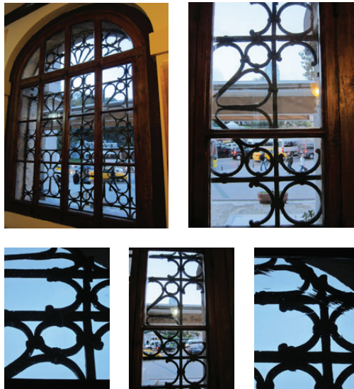
Resim 5. Dolmabahçe, Bezm-i Âlem Valide Sultan Camii giriş kapısı sağ tarafında bulunan pencere genel ve detay fotoğrafları.
