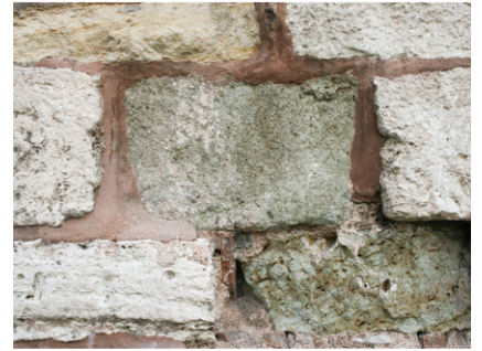
Şekil 25. Yeşil renkli Karamürsel od taşında görülen erozyon ve oksidasyon (Fotograf: S. Angi).
