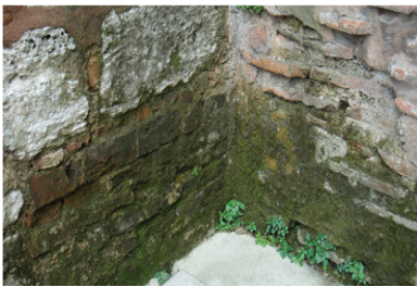
Şekil 26. Küfeki taşı ve tuğlalarda görülen yosunlaşma ve bitki oluşumu (Fotograf: S. Angi).
