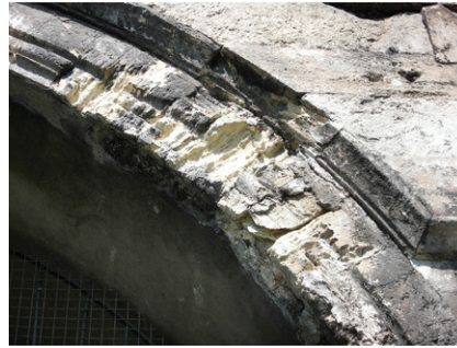
Şekil 24. Küfeki taşında görülen erozyon ve siyah tuz (jips) kabuğu oluşumu (Fotograf: S. Angi).
