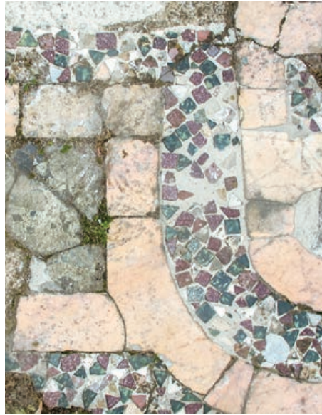
Şekil 13. Studios Bazilikası naos döşemesinde görülen onarım izleri
