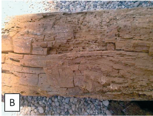
Şekil 3. A ve B, Bodrum kat onarımı öncesi çürüklük mantarlarının oluşturduğu hasarlar
