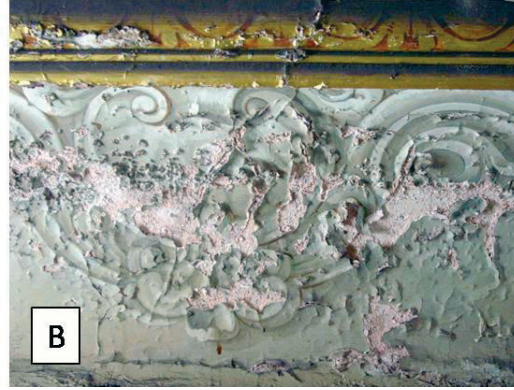
Şekil 2. A: Birinci kat 164 numaralı oda tavan eteği, B: Birinci kat 32 numaralı salonda onarım öncesi tespit edilen çiçeklenme ve boya dökülmeleri
