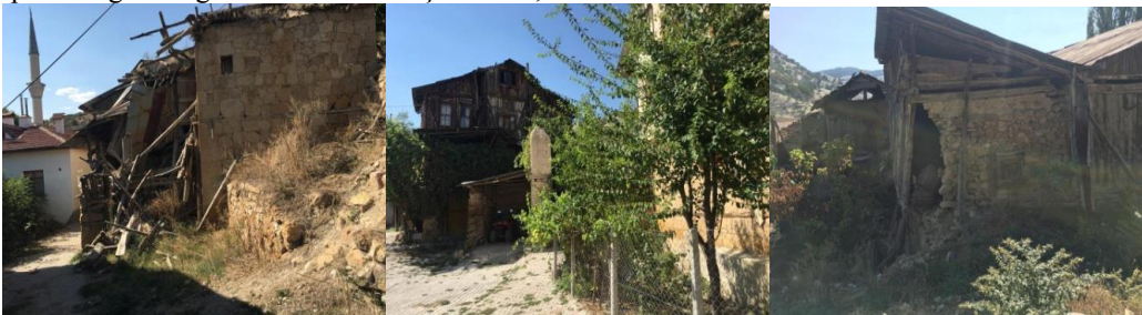
Şekil 19. Yapılardaki tahribat örnekleri
