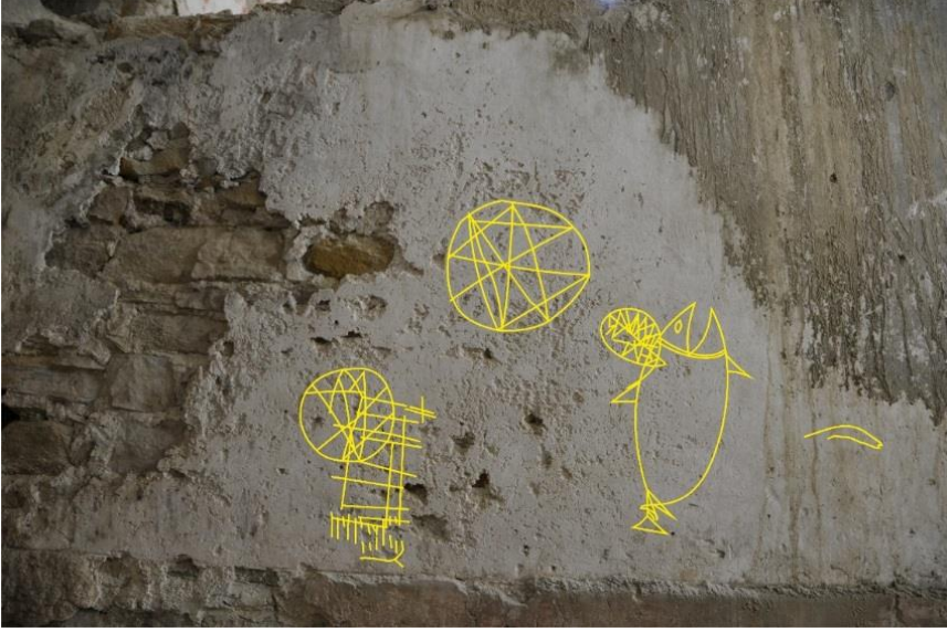
Resim 16: Ihlıklık Mekânındaki Perde Duvarın Kuzeyindeki Grafitiler.
