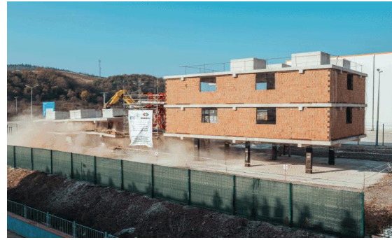
Şekil 1. Yıkılan bina ve FRP ile güçlendirilip ayakta kalan bina
