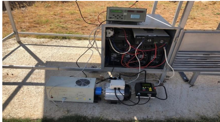
Şekil 7. Deneysel uygulama sistemi
