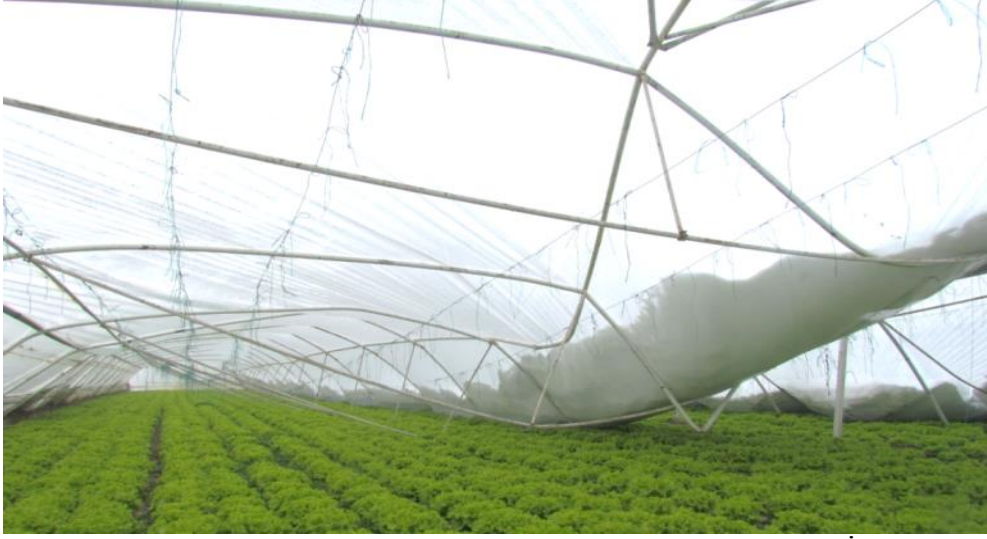
Şekil 3. Kar yükü sonucu konstrüksiyonda meydana gelen zarar (Yalova-İşletme no:10) Figure 3. Damage to the construction caused by snow load (Yalova- Enterprise no: 10)
