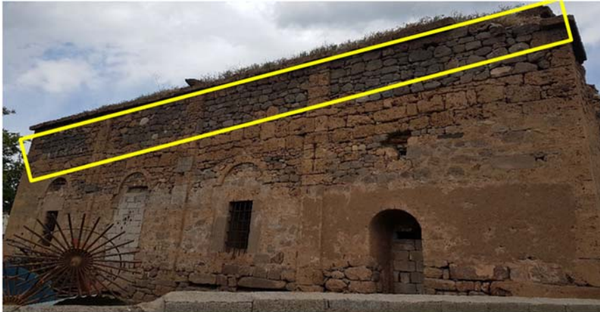
Şekil 11. Kilise dış cephe duvar görüntüsü (Outer façade wall view of the church)
