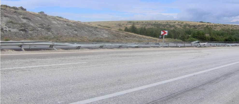
Şekil 6. Üçüncü Kurb Üzerinde Hasar Görmüş Bariyerler
