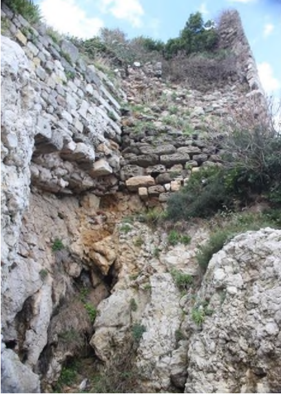
Şekil Hata! Belgede belirtilen stilde metne rastlanmadı.4: Bozetepe Kuzey Sur Hattında Bulunan ve Yıkılmakta Olan Burç Yapısı
