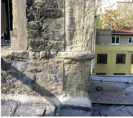
Şekil 21. Çan kulesi köşe pilastırlarında kullanılmış olan arkozik kumtaşı (Batı çan kulesi)
