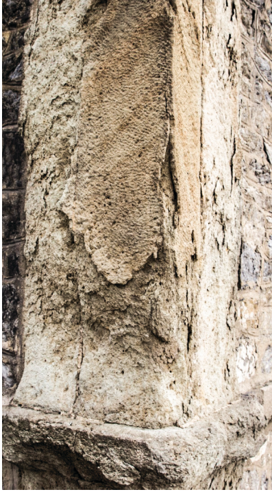
Sekil 27. Kumtaşı köşe pilastırlarında görülen aşınma ve kopmalar (Doğu çan kulesi)
