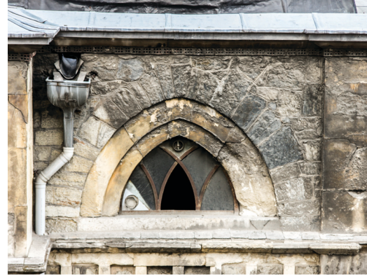
Şekil 23. Kuvars vake (grovak) duvar yüzeyinde hava kirliliğine bağlı kabuk oluşumu (Kuzeybatı cephesi)
