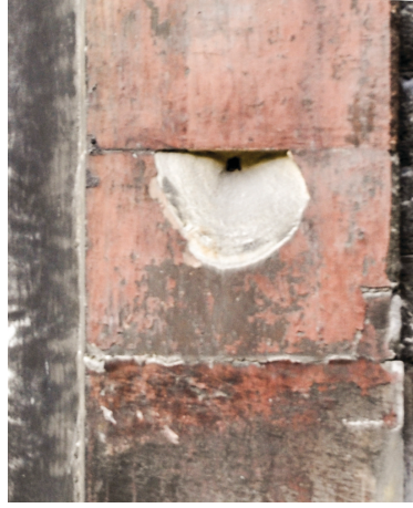
Sekil 25. Biyomikritik kireçtaşı pilastırlarda metal korozyonuna bağlı parça kopması (Kuzeybatı cephesi)
