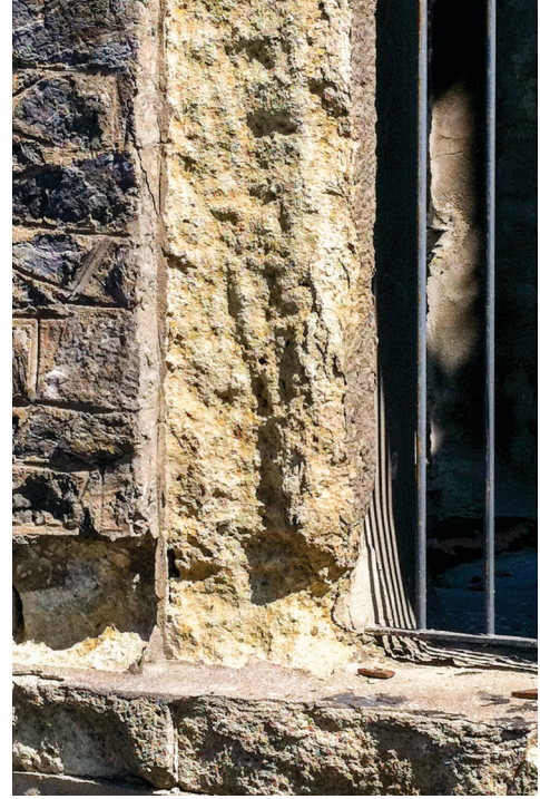
Sekil 29. Od taşı sövelerde aşınma ve yüzey kayıpları (Doğu çan kulesi)
