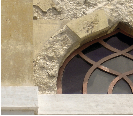
Sekil 24. Biyomikritik kireçtaşı kemer taşlarında görülen yüzey kaybı (Güneybatı cephesi)
