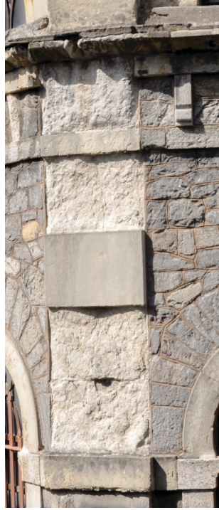
Sekil 28. Biyomikritik kireçtaşı pilastırda yüzey kaybı (Kuzeydoğu cephesi)
