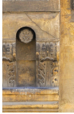
Şekil 22. Malta taşı konsol taşlarında kabuk oluşumu ve çatlaklar (Kuzeybatı cephesi)
