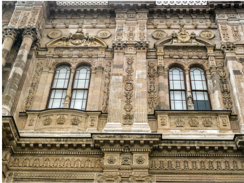
Şekil 2. Muayede Salonu deniz cephesinde yoğun bezeme düzeni ile özgün ve dönem onarımlarında ilave edilmiş olan farklı cins yapı taşlarının görünümü.
