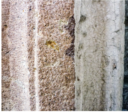
Şekil 14. Muayede Salonu deniz cephesi duvarı üzerinde, dönem onarımlarına ait tarak izleri ve raspa edilmemiş kısımlarda mevcut macun ve boya tabakaları
