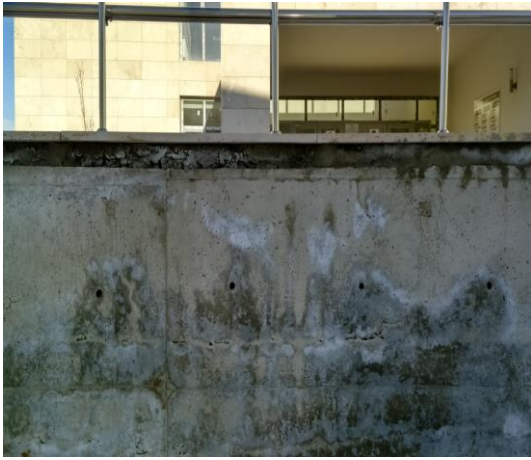
Şekil 11. İstinat duvarı perde betonunda su-nem ve don etkisi ile oluşan görsel kirlilik.
