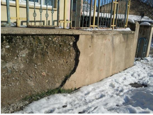
Şekil 6. Beton istinat duvarı perde betonundaki sıvaların su-nem ve don etkisi ile dökülmesi.
