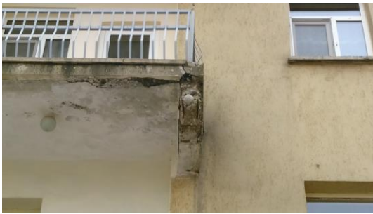
Şekil 8. Balkon su giderinin uygunsuz çözümü sonucunda oluşan döşeme ve kiriş betonlarında parça kopması hasarı ve kirişte donatı korozyonu hasarı, balkonda damlalık yapılmadığı için tavan boyasında hasar oluşması.
