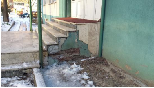
Şekil 7. Bina girişi merdiven cephesinde su-nemden kaynaklanan taş kaplamada kırılma hasarı, boya ve sıvada dökülme hasarları.
