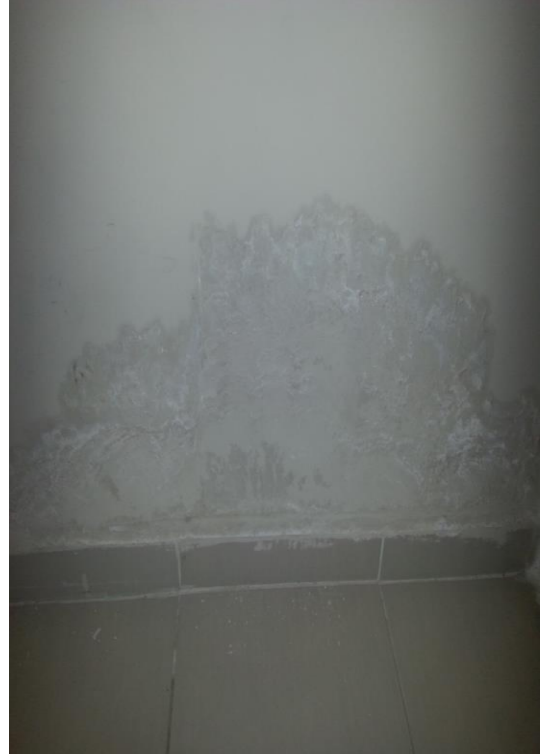
Şekil 16. Konuttaki ıslak hacimlerden olan banyo duvarlarının ıslanması sonucunda, hol (antre) cephesindeki duvarda gözlenen su-nem kaynaklı boya hasarları.
