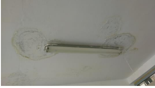
Şekil 10. Tavanda meydana gelen kabarma, dağılma şeklindeki boya hasarları.
