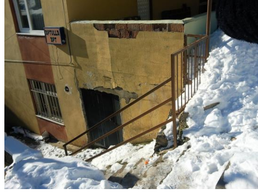
Şekil 15. Yapı dış cephesinde su-nem kaynaklı boya ve sıvanın birlikte kabarma ve kopma şeklinde görülen cephe hasarları.
