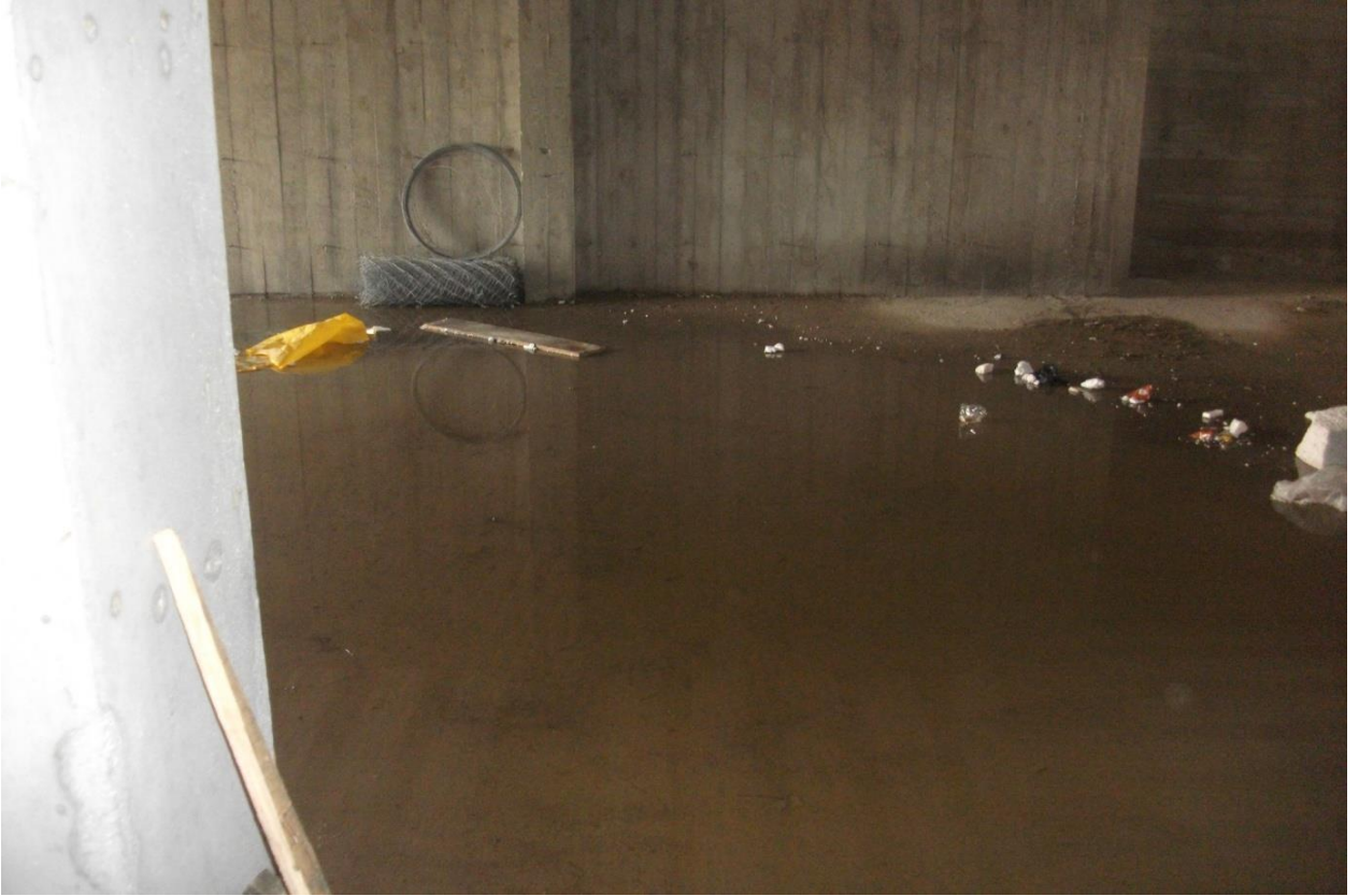
Şekil 2. Bodrum katı sular içinde kalmış betonarme bir yapı.
