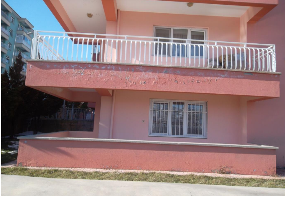
Şekil 17. Yapı dış cephesinde bankondaki uygunsuz su gider yerinden kaynaklanan boya kabarması ve kopması şeklinde görülen cephe hasarı ve ayrıca balkonda damlalık yapılmadığı için tüm cephede boya hasarları.
