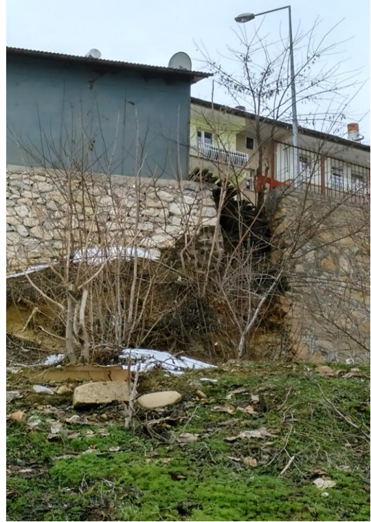
Şekil 13. Taş istinat duvarında barbakan bırakılmaması sebebi ile çatı sularının taş istinat duvarında oluşturduğu yıkılma hasarı.
