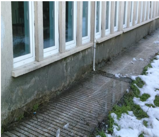
Şekil 12. Zemin kat yapı cephesinde kapilarite (kılcal su yükselmesi) sonucu oluşan görsel kirlilik ve bakteri oluşumu
