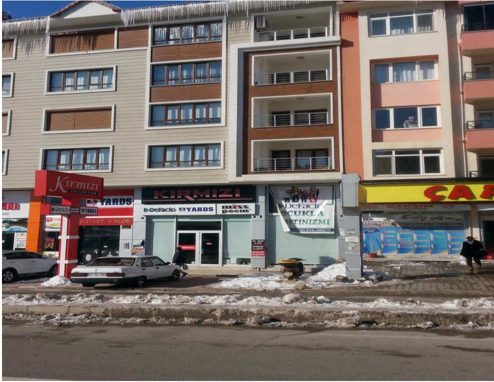
Şekil 18. Yoğun kullanılan bir caddede çatıda oluşan buz parçalarının kaldırımda yürüyenler için oluşturduğu büyük tehlike ve çatı saçağında oluşturacağı kar-buz yükü.
