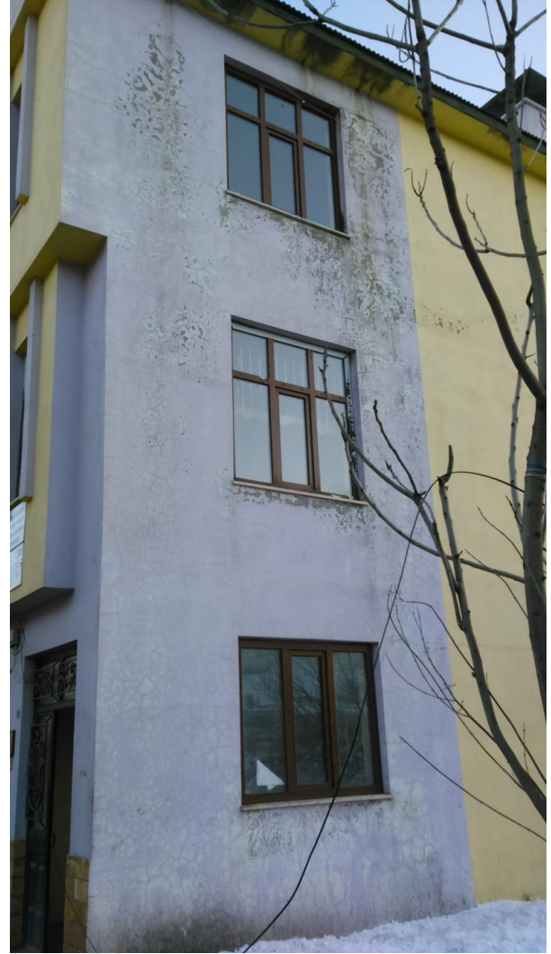
Şekil 9. Yağmur oluşunun zarar görmesi sonucu yapı cephesinde meydana gelen boya hasarları.
