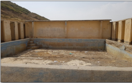
Şekil 6: Kullanım dışı bırakılan kaplıca binası
