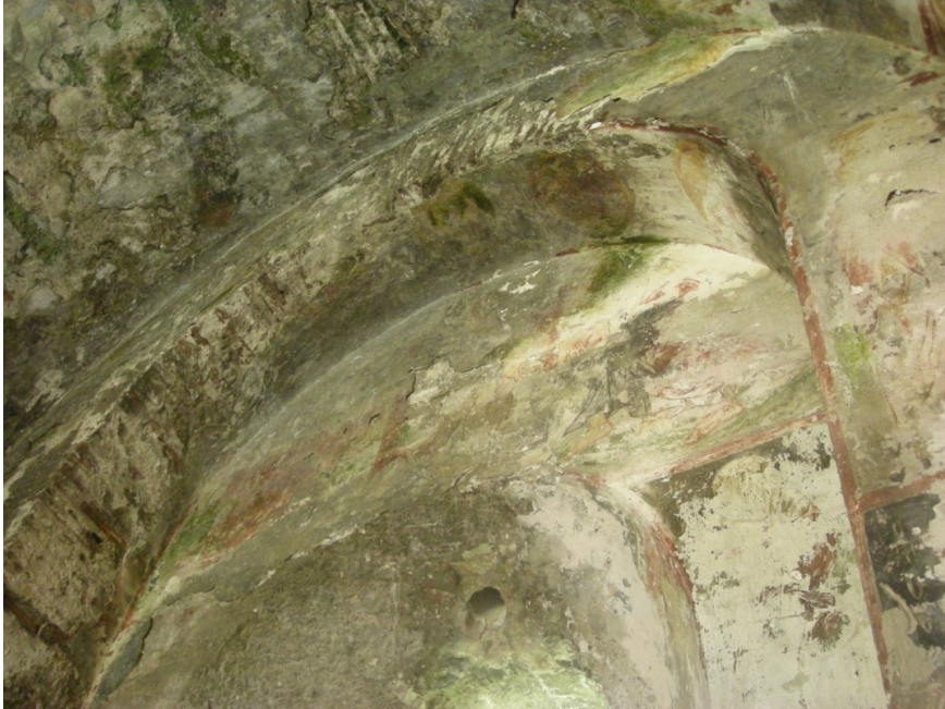
Fig. 6 Kaba sıva ile duvar arasında yer alan boşlukların lokal alanlarda sebep olduğu sıva kayıpları. Hande Günözü.
