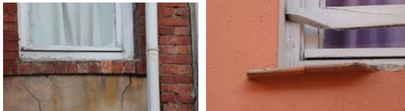
Şekil 13. Yan yüklerden dolayı formu bozulan denizlikler (Figure 13. Sills whose form is deteriorated due to side loads)
