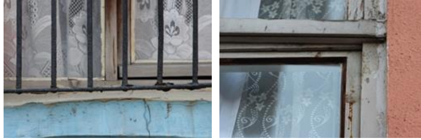
Şekil 10. Ahşap pencerelerde budak ve reçine sorunu (Figure 10. Knot and resin problem in wooden windows)
