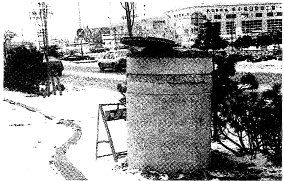
Şekil 13: Kushiro-oki depreminde (Japonya) Kushiro kentinde gözlenen kanalizasyon kuyusunun yükselmesi
