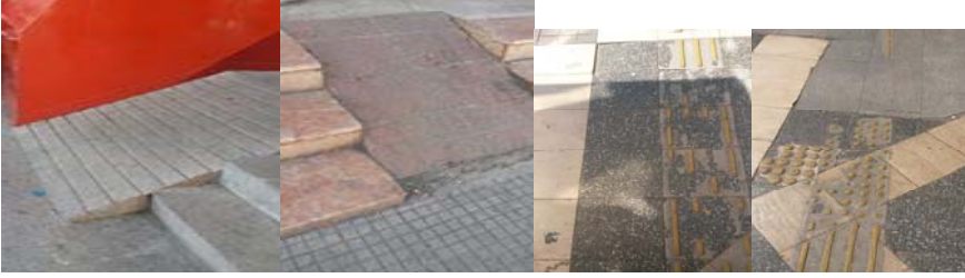
Resim 1: Şehir Merkezinde Engelli Kullanımı İçin Uygun Olmayan Rampa ve Hassas Yüzey Örnekleri
