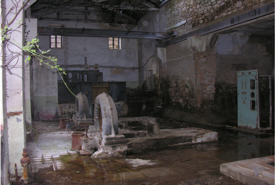
Gökpınar I Hidroelektrik Santral Binası İçeriden Görünüşü (8 Şubat 2018)
