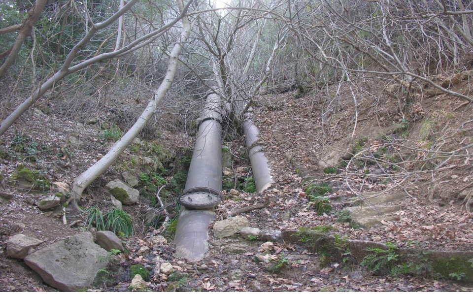
Gökpınar I Hidroelektrik Santrali Cebri Boru (solda) (Yanına sonradan içme suyu için bir başka boru yerleştirilmiştir) (8 Şubat 2018)
