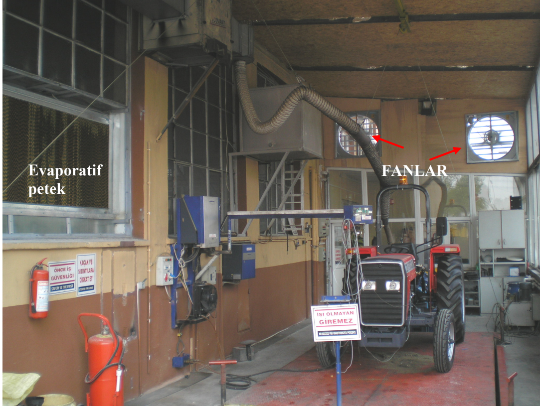
Şekil 5. TAMTEST'e kurulan evaporatif soğutma sistemi
