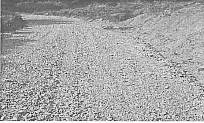
Figure 7. The condition of a part of paved road – one year later (Photo: T.Ozturk) Şekil 7. Bir yıl sonra üstyapı yapılmış yolun bir bölümünün durumu
