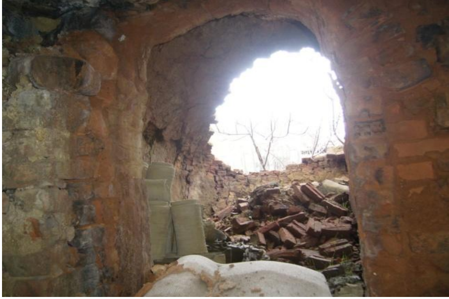
Şekil 6: M. Çıra'ya ait yıkık durumdaki çömlekçi fırını Kaynak: Fotoğraf Sevcan Ölçer, 2011
