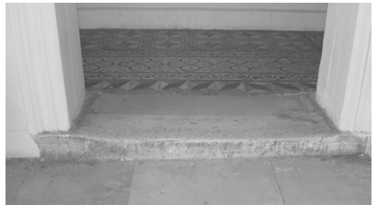
Resim 15: İç mekanda mermer ve karo döşeme
