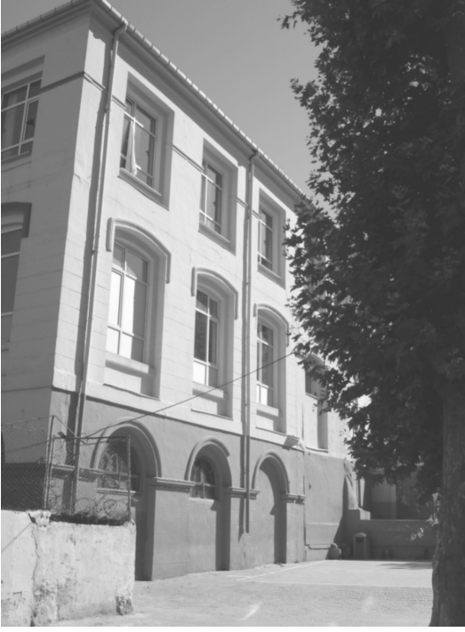
Resim 17: Kuzey cephede kapatılan pencereler
