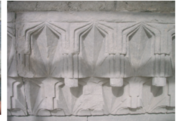
Şekil 30. Şekil 29'daki yüzeyin temizlik sonrası görünümü
