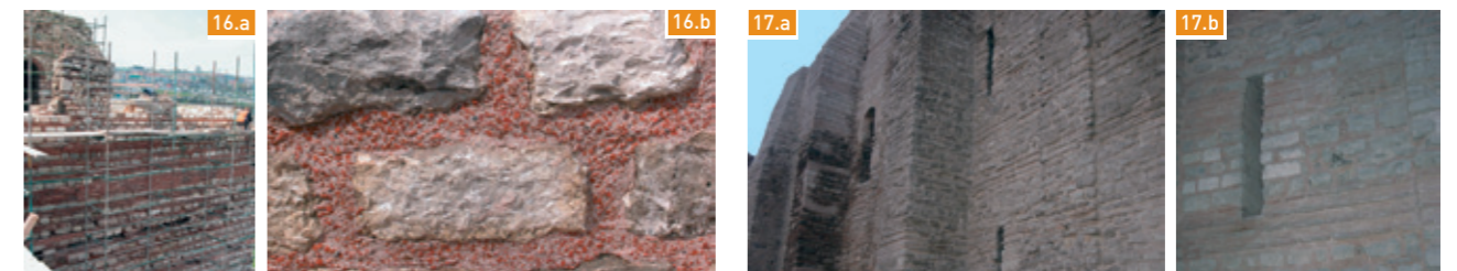
Şekil 16. a. b.) Anemas Zindanları'nın restorasyonu sırasında kullanılan onarım harcının durumu (2006)
