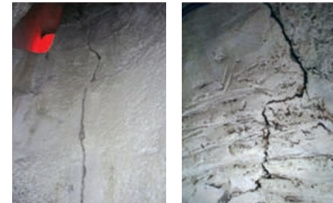
Şekil 8. Minarenin iç kısımlarında meydana gelen çatlaklar
