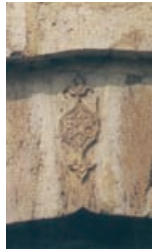
Resim 18. Köprü üzerindeki bitkisel bezemelerden
