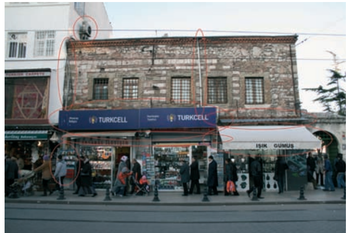
Şekil 56. Atık Ali Külliyesi'ne ait Muvakkithane - Sıbyan Mektebi cephesinde tabela, tente, hatalı uygulanmış yağmur iniş borusu ve klima eklentileri (İ.SAĞDIÇ; 2011)
