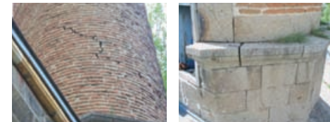
Şekil 9. Minarenin dış kısmında görülen makro çatlaklar
